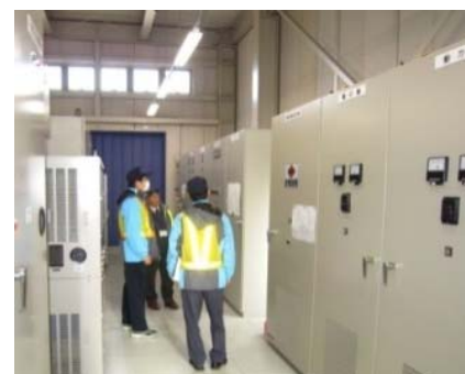
(城川原変電所)
